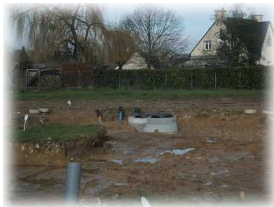
Viabilisation du lotissement Gondet situé entre les rues Théodore Botrel et La Chesnais
